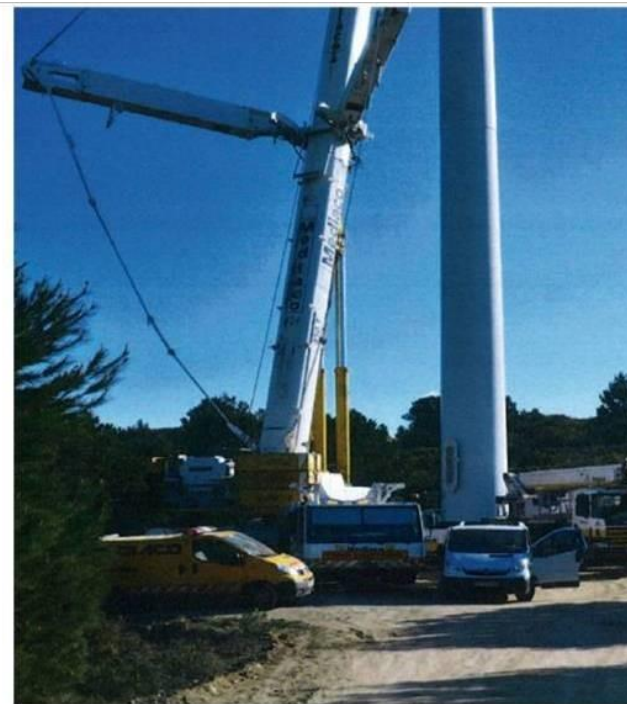
2 - Mise en place des engins de matutention (Grues, tracteurs et camions navettes) au pied de l'éolienne
