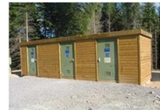
Poste de livraison
